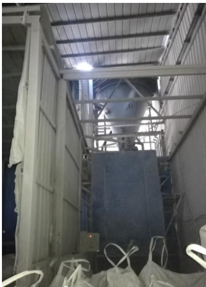
1#生产车间除尘器
