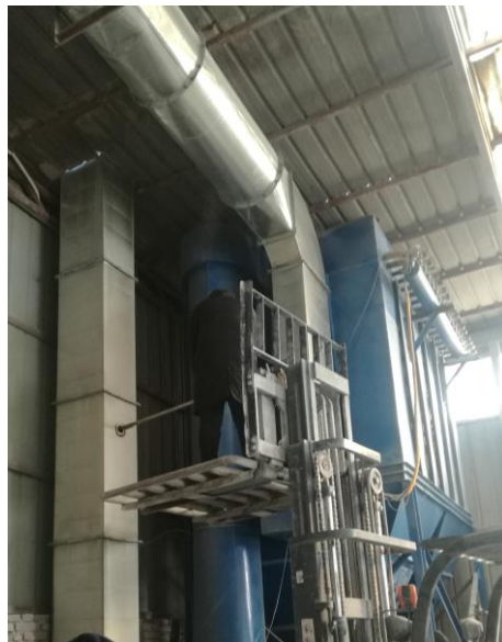
1#生产车间除尘器
