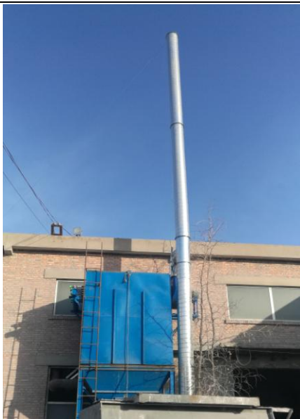
2#生产车间除尘器
